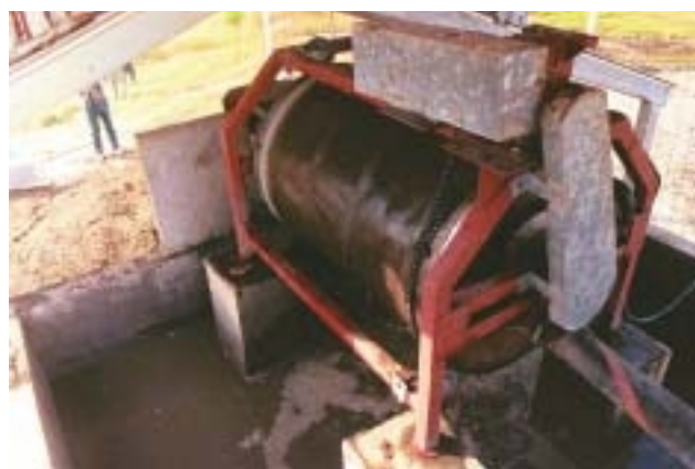
Laguna de oxidación
